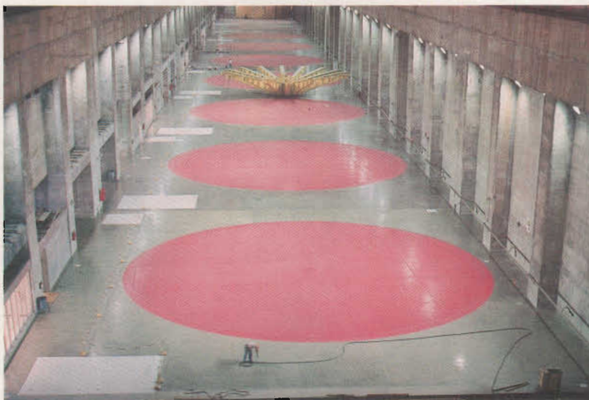
Visión completa del sector de 50 Hz de la casa de máquinas, con todas sus nueve máquinas montadas y en funcionamiento.
